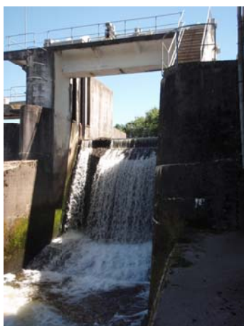
Photo n° 7 : Vanne de chasse
